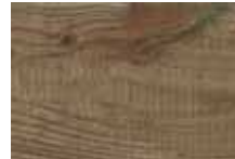
Rauhe Stellen auf der Holzoberfläche
