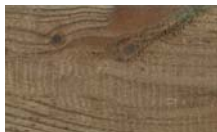
Rauhe Stellen auf der Holzoberfläche
