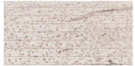
Stockflecken/Schimmel auf der Oberfläche
